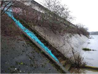
Photo 1 – Vers l'aval, le talus bétonné est très haut. Seule la partie supérieure est colonisée par la végétation
