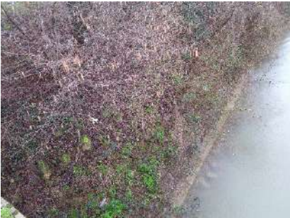
Photo 4 – La partie inférieure en enrochement disparaît sous la végétation herbacée
